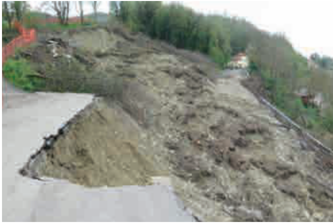
Foto 19 - Località Boschetto (Comune di Tizzano V.P.): vista della frana dal lato di monte (fine aprile 2013, foto Triches).
