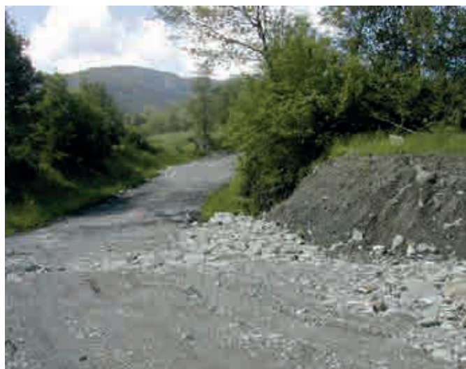
Foto 1a – S.P. 74, località Staiola (Comune di Corniglio): il dissesto ha fatto slittare il piano stradale di oltre 10 metri verso valle (giugno 2013, foto Pelosio).
