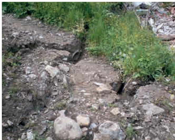
Foto 4 – Sauna (Comune di Corniglio): lesione di uno scarico fognario causato dal movimento franoso (maggio 2013, foto Molinari).
