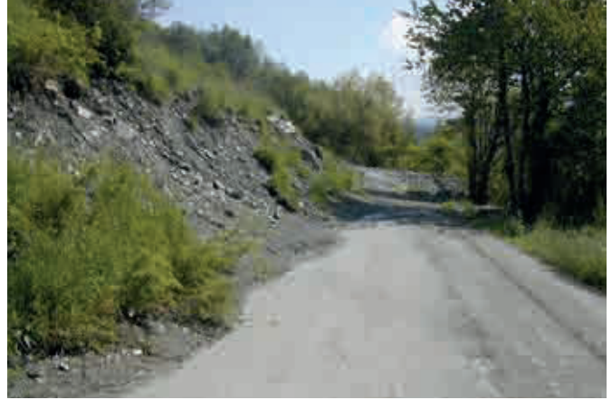
Foto 6 – Località Staiola (Comune di Corniglio): i depositi detritici gravitativi, quasi saturi, che stanno sormontando la S.P. 74 (giugno 2013, foto Pelosio).
