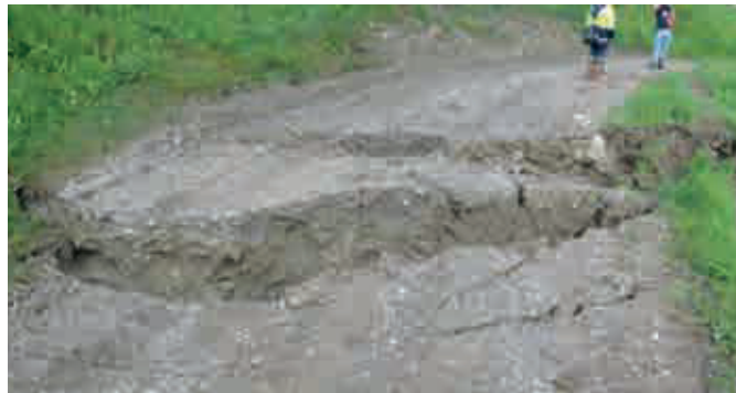
Foto 17 - Località Sauna (Comune di Corniglio): il coinvolgimento nel dissesto dell'abitato è stato preannunciato dall'apertura di profonde crepe lungo le strade vicinali soprastanti il paese (fine aprile 2013, foto Triches).
