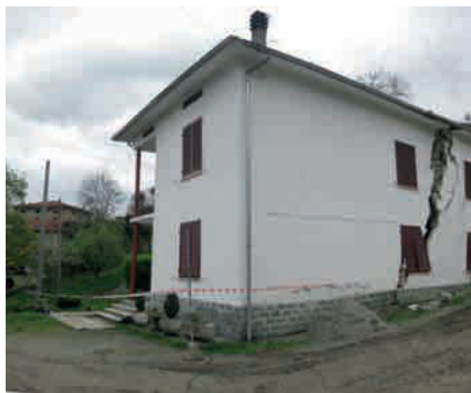
Foto 18 - Località Sauna (Comune di Corniglio): una delle abitazioni danneggiate dalla frana, qualche ora prima del suo abbattimento definitivo (fine aprile 2013, foto Triches).
