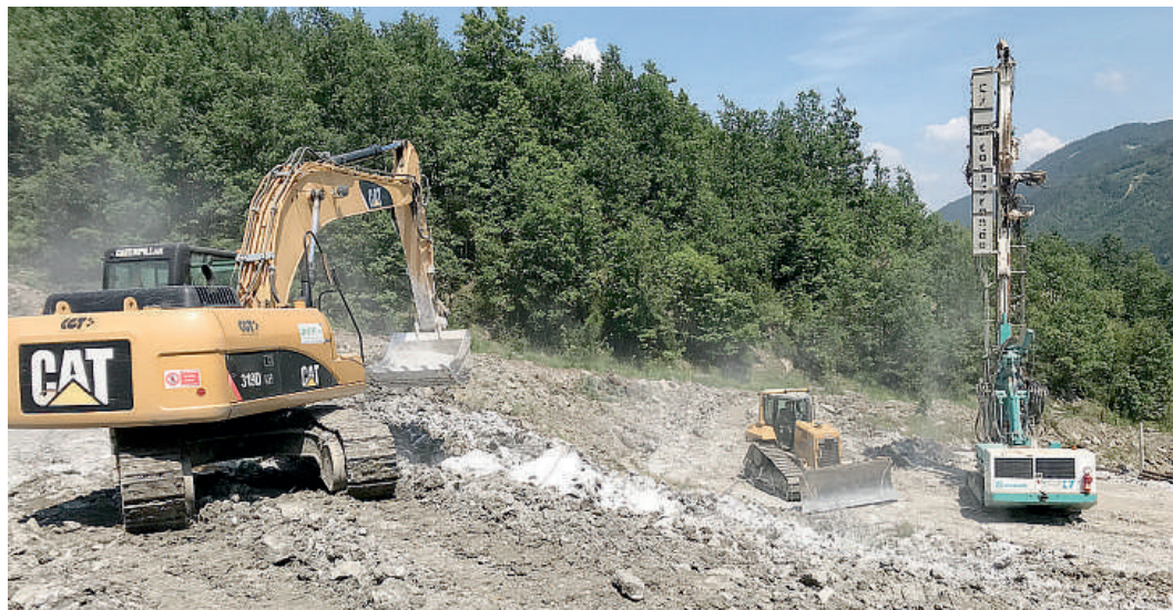
Ruspe al lavoro ai Sassi Neri, dopo la frana la Regione ha finanziato l'intervento con 1 milione di euro
