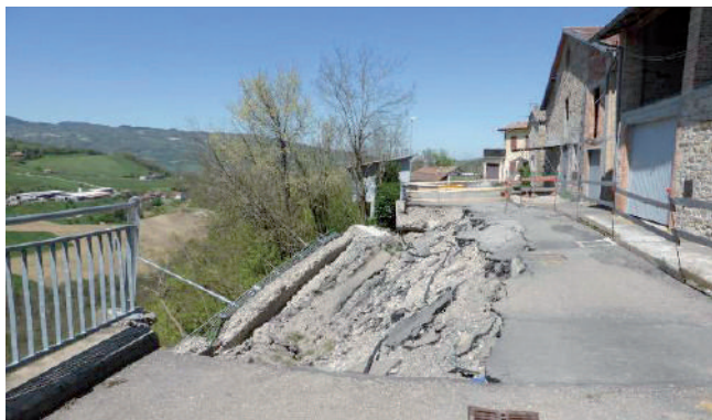
FIGURA 28 - Situazione in seguito all'evento 2014. Compromessi la strada interna al paese e gli edifici prospicienti
