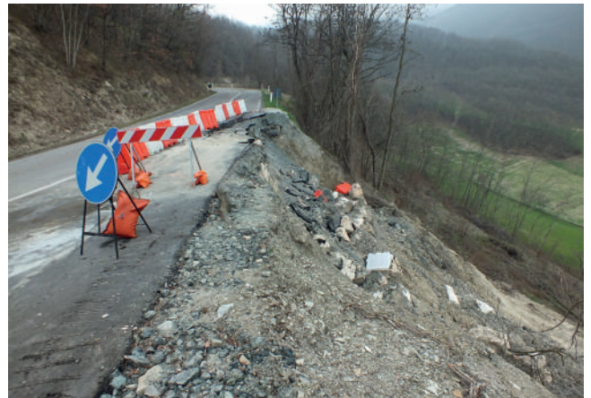
FIGURA 9 – Situazione di tipo c) che interessa la SP 15 Calestano –Berceto (PR), con coinvolgimento parziale della carreggiata. Per sicurezza la strada è rimasta interrotta per circa un mese tra Febbraio e Marzo 2014
