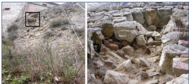
Figura 6. Danni al paramento del muro del 3° piazzale della fortezza.
