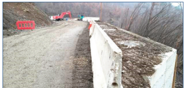
Figura 18. L'intervento strutturale completato, con in primo piano il paramento del muro in elevazione ed i chiusini d'ispezione dei pozzi drenanti.
