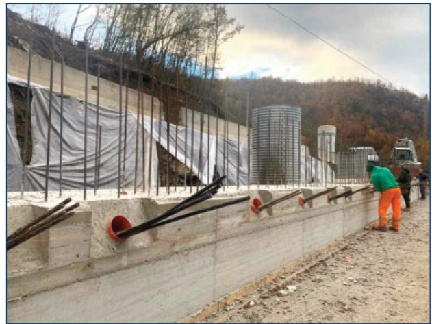
Figura 17. La trave di testa di collegamento dei pali, con i tiranti d'ancoraggio prima della loro tesatura. Si notano in secondo piano i lamierini dei pozzi drenanti portati alla quota finale del piano viario.
