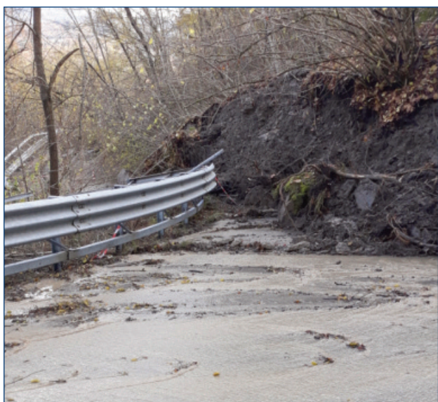
Figura 2. Effetti della frana sulla SP654R.
