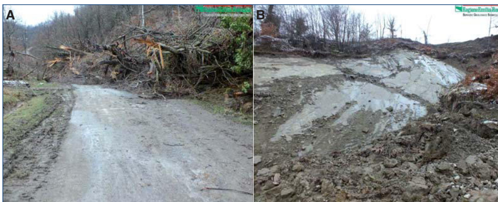
Figura 20. Particolari della frana di Raggiale (Bagno di Romagna, FC). A: accumulo del piede sulla strada comunale; B: particolare della superficie di scorrimento in roccia nella porzione mediana (foto del SGSS).
