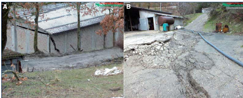
Figura 22. Danni provocati dalla frana in loc. Il Terzo (Bagno di Romagna, FC) (foto del SGSS).
