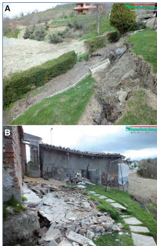
Figura 16. Danni nei pressi del coronamento della frana di Rontagnano (Sogliano al Rubicone, FC) (foto del SGSS).
