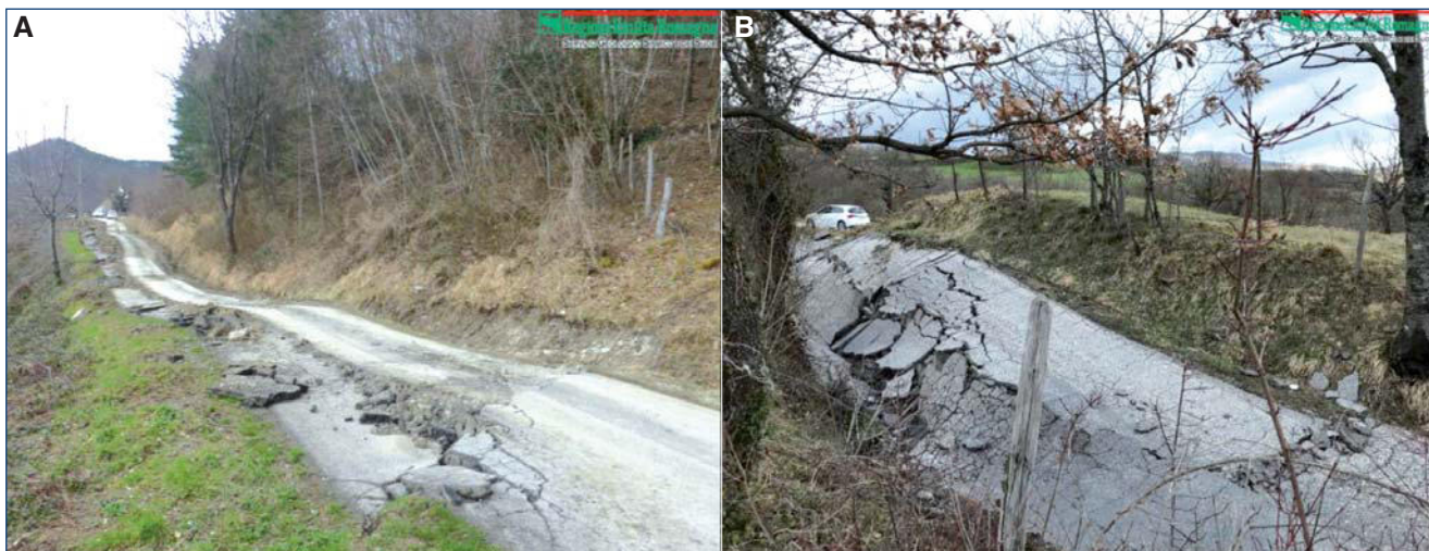
Figura 19. Strade danneggiate dalla frana di Corneto (Verghereto, FC). A: zona di coronamento; B: zona medio bassa dell'accumulo (foto del SGSS).
