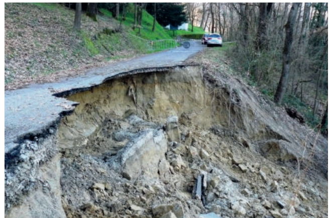
FIGURA 10 – Situazione di tipo c) in Comune di Monzuno (BO), con interruzione totale della viabilità
