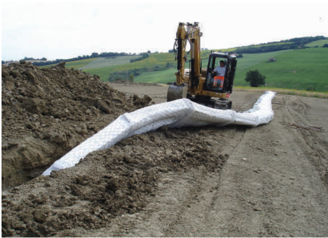
FOTO 2 - Operazioni di posa in trincea del sistema drenante. Si noti come parte della trincea si già alloggiata in scavo mentre in fondo si prosegue con il montaggio della linea in sicurezza fuori dallo scavo
