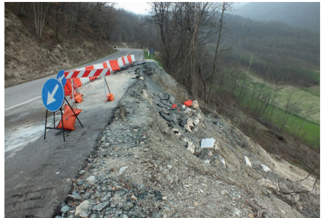
FIGURA 9 – Situazione di tipo c) che interessa la SP 15 Calestano –Berceto (PR), con coinvolgimento parziale della carreggiata. Per sicurezza la strada è rimasta interrotta per circa un mese tra Febbraio e Marzo 2014
