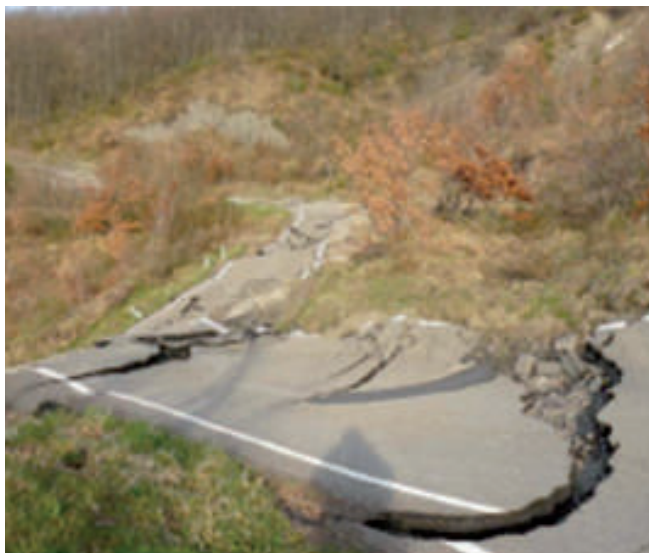
FIGURA 22 - Lesioni alla strada Comunale di Sparvo in loc. Murricce
