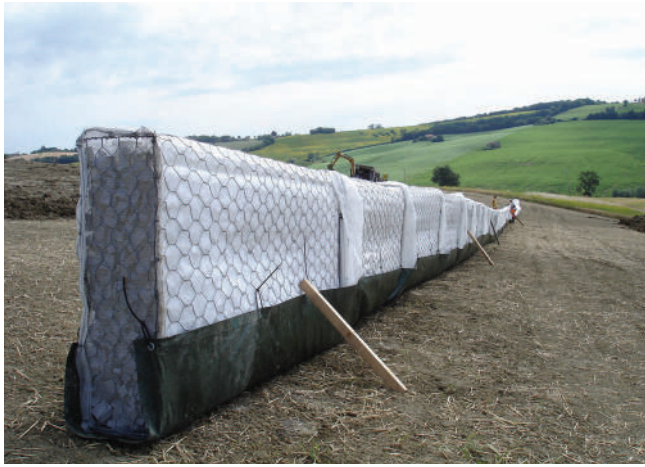
FOTO 1 - Fasi di montaggio di uno dei bracci della linea drenante. Si noti la guaina impermeabile al fondo del pannelli
