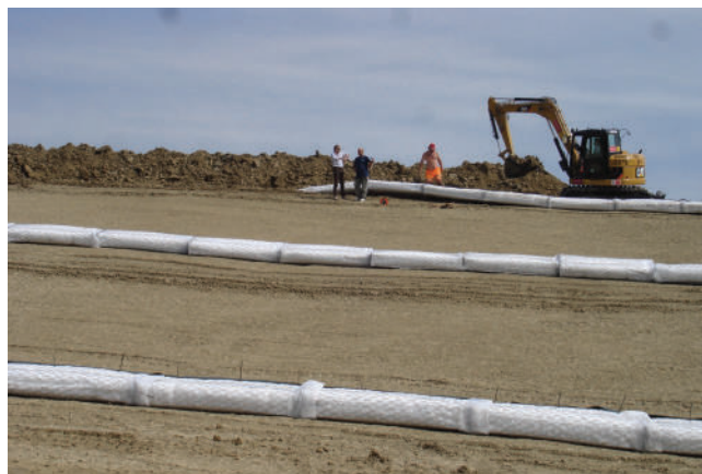
FOTO 5 - Vista del pendio da valle. Sono evidenti le linee drenanti parallele già montate e pronte alla posa in scavo
