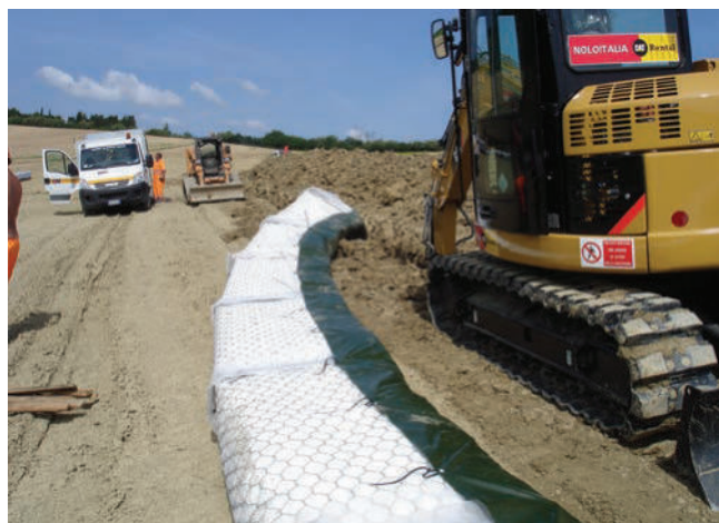
FOTO 4 - Fasi di lavoro con i mezzi di scavo e di movimento terra. L'organizzazione del lavoro e velocità di posa hanno permesso la realizzazione dell'intero sistema drenante in meno di dieci giorni
