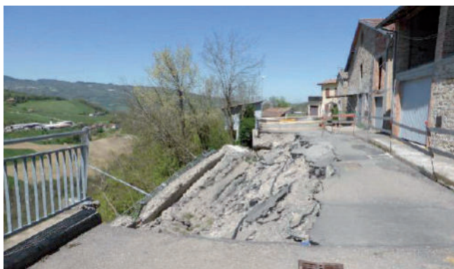
FIGURA 28 - Situazione in seguito all'evento 2014. Compromessi la strada interna al paese e gli edifici prospicienti
