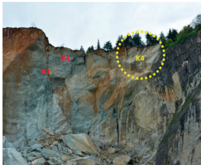
Fig. 36 - Fascia di parete rocciosa intensamente fratturata con intersezione dei due sistemi di frattura K1 e K4.
