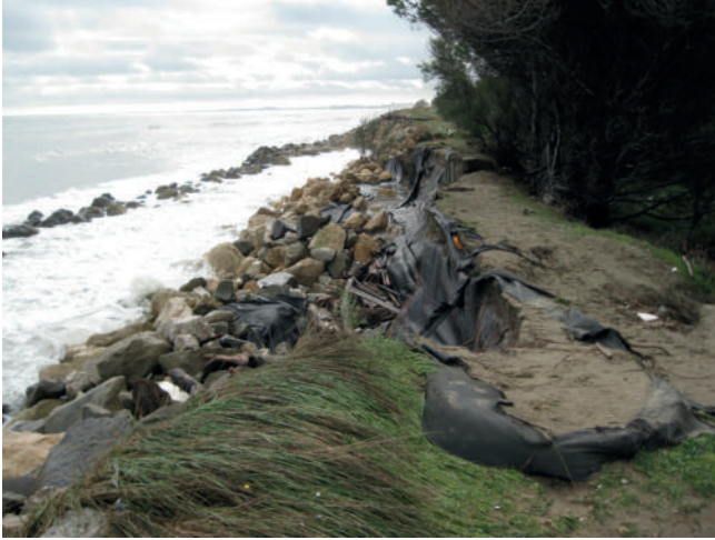
Fig. 6 - Esempio di danneggiamento di un tratto di argine a mare nel territorio ferrarese.
