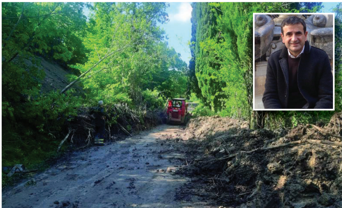
UNA FASE DEI LAVORI DI SGOMBERO IN COLLINA A MODIGLIANA. NEL RIQUADRO PARIDE ANTOLINI
