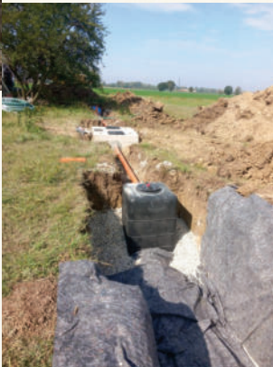
Pozzo di cacciata
