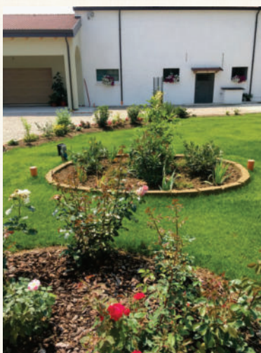
Fitodepurazione in esercizio. Rodigo (MN)
