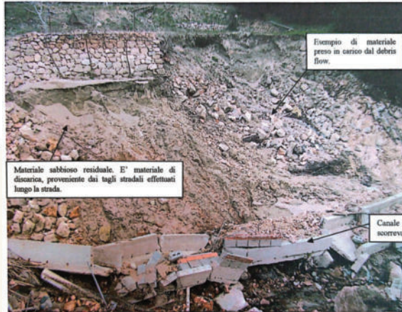
Immagine 14 - Sponda del torrente affluente del Rio S'arrescotti in cui è stato messo alla luce il porfido. Lungo i versanti sono ancora presenti blocchi e clasti, il materiale sabbioso è stato portato via andando a costituire la matrice solida debris flow. Strada comunale Sarguara.
